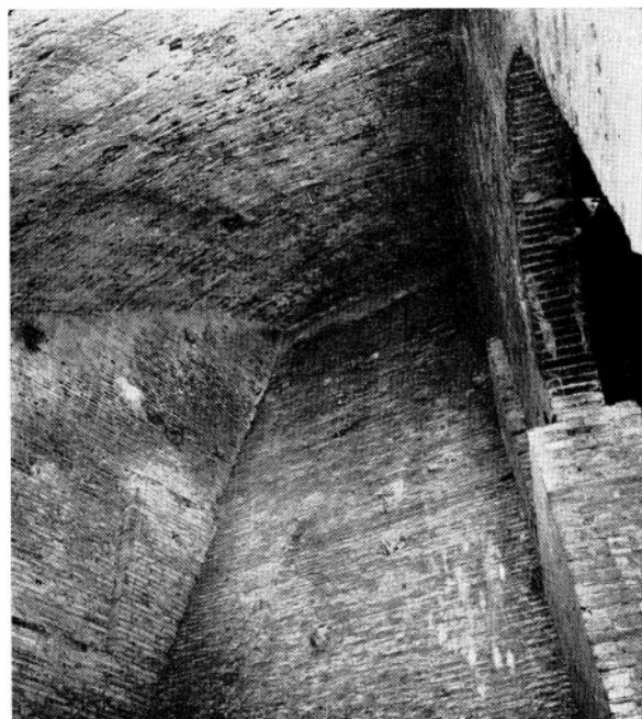
FIG. 34 - PISA, BATTISTERO - Appoggio sulla volta interna degli elementi trasversali reggenti la calotta esterna.
